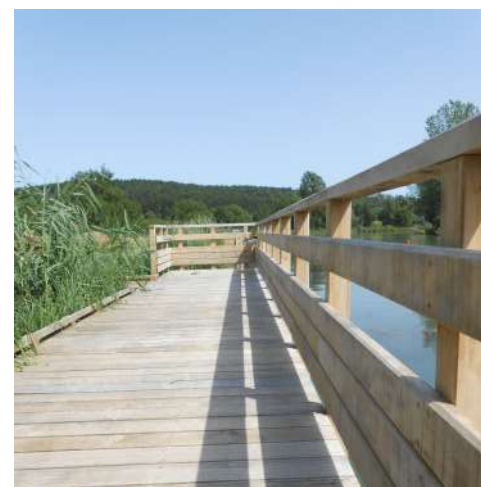
Ponton et Garde-corps en bois
